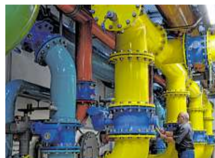
Bunte dicke Rohre im Wasserwerk Neugraben Roland Magunia, Bertold Fabricius
